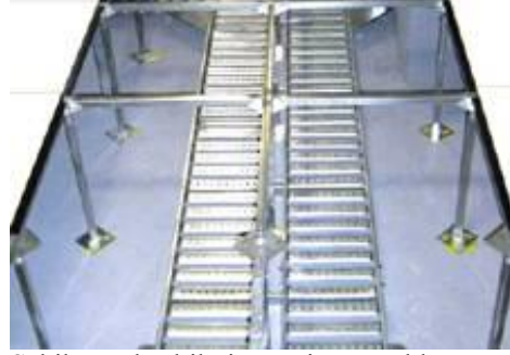
Şekil 5 Yükseltilmiş Zemin ve Kablo Kanalları [3]
